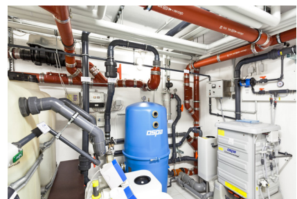
Kompakte Installation: Blick auf die Ospa-Schwimmbadtechnik im Untergeschoss der Anlage.
